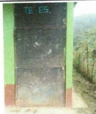
Foto 2: Imagen de puerta de metal de establecimiento que necesita ser cambiada ya que no se encuentra en óptimas condiciones.
