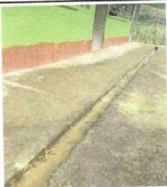
Foto 1: Se observa la necesidad de reparación de cuneta del establecimiento.
