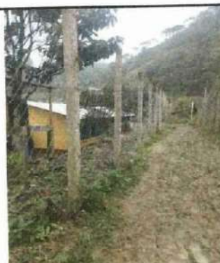
Foto 4: Fotografía lateral de establecimiento en donde se puede observar la necesidad de reparación de muro perimetral para mejor seguridad de los niños
