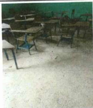
Foto 3: Imagen de piso dentro del establecimiento en donde se puede observar que es necesario colocar el piso cerámico ya que actualmente está en mal estado.
